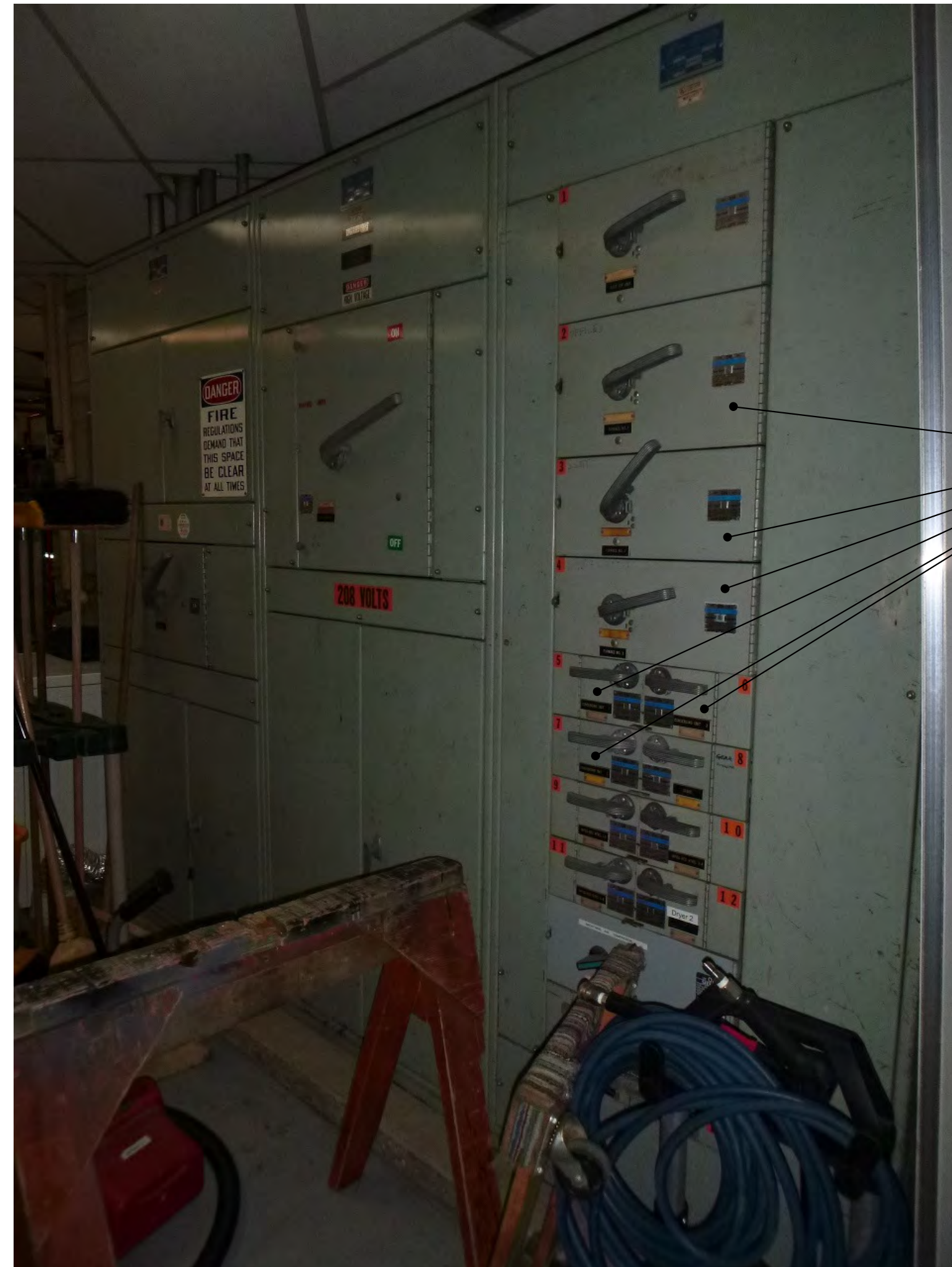
① EXISTING MAIN SWITCHBOARD N.T.S.
